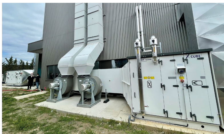
Exemple de CTA Atex de rejet avec récupération - Projet Solvionic
